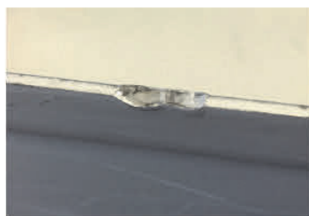
縁の欠損、変形
