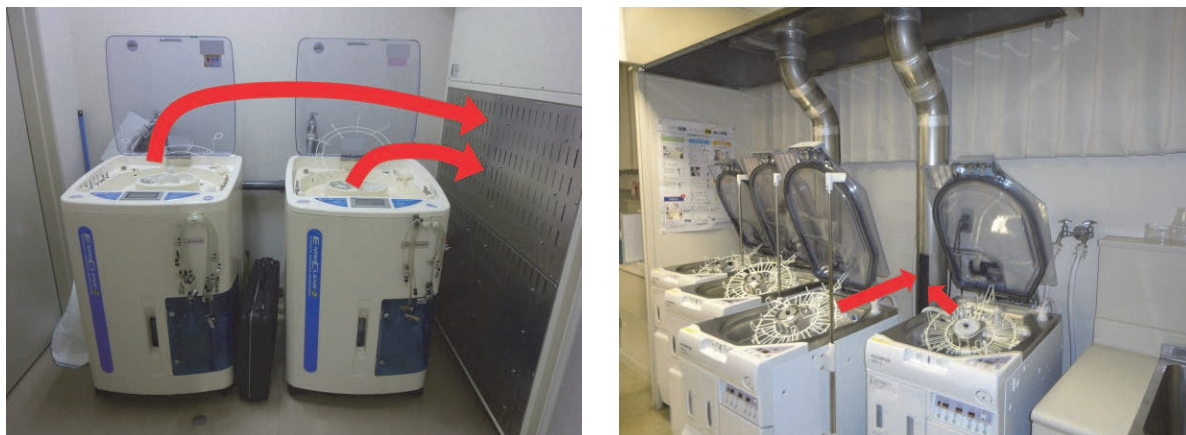
図17-4 内視鏡自動洗浄消毒器と換気装置例 (矢印は空気の流れを示している)
